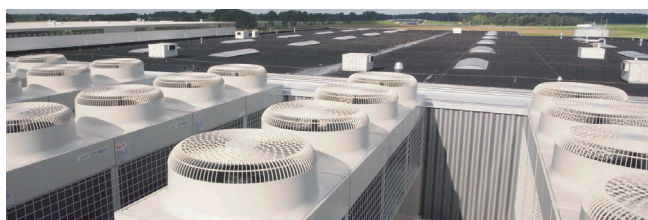
Venkovní jednotky tepelných čerpadel City-Multi (HPB).
